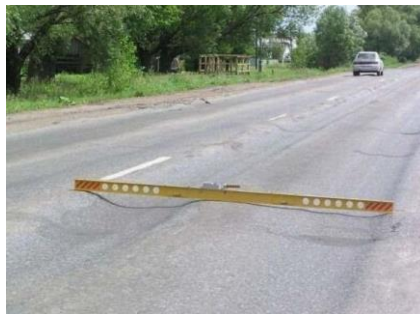
Рисунок 1 – Колія на асфальтобетонному покритті
